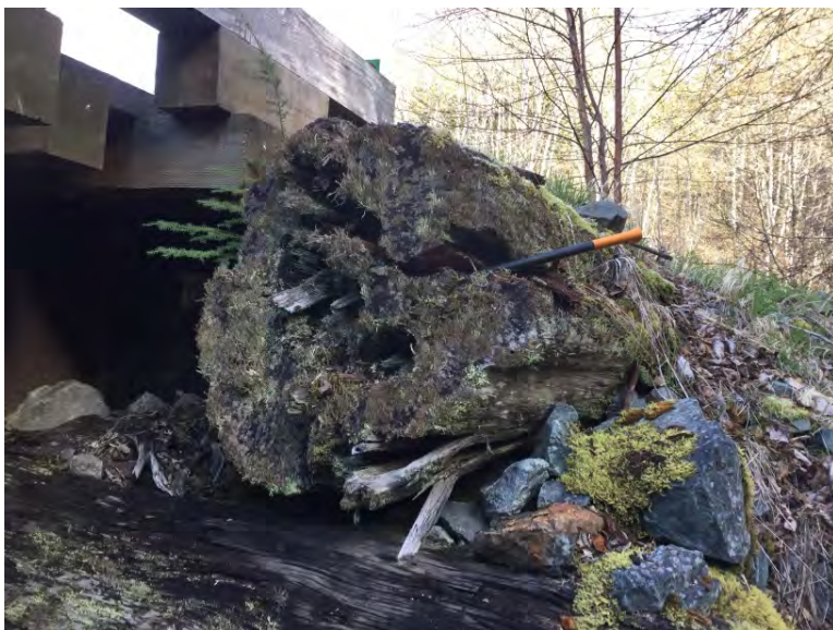
Fill retention logs rotten
